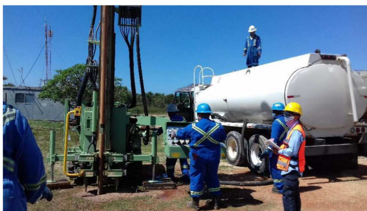
Fig. 3. Perforación de pozo de observación y ensayo de carga (Foto del autor)
