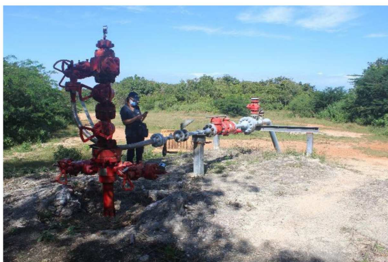
Fig. 2. Pozo productor abandonado en la Granja de Crudos Pesados del Norte de La Habana-Matanzas equipado para inyectar aguas producidas (Foto del autor).
