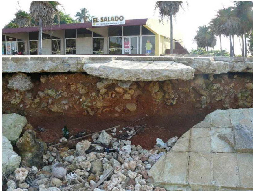
Fig. 9. Erosión costera, lavado de la terraza y desmantelamiento del vial en 2016 (Foto LML)
