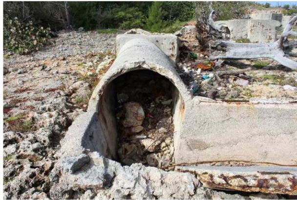
Fig. 14. Antiguas estructuras de defensa militar costera abandonadas y muy deterioradas (Foto LML)
