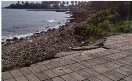
Fig. 26. Deterioro de las aceras por pérdida de arena debido al retroceso de la playa en el Salado (Foto de 2001 por María Luisa González)
