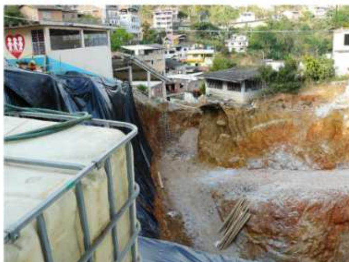
Fig. 3. Hundimiento (subsistencia) de la Unidad Educativa La Inmaculada, Zaruma (Foto del autor)
